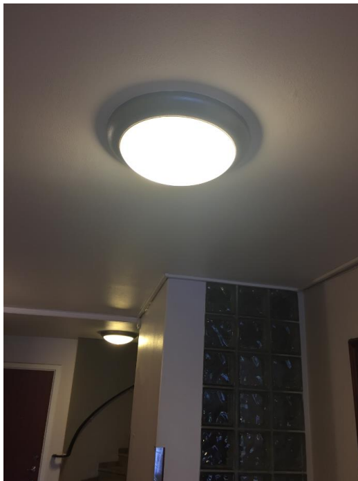
Figur 10. Belysning av nyare typ i trapphus med rörelsedetektor.
