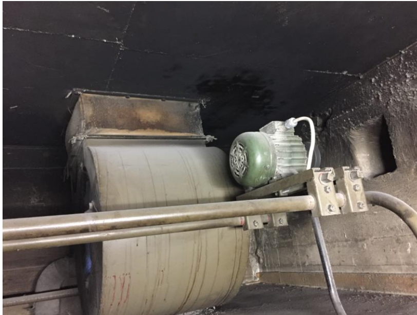
Figur 7. Frånluftsfläkt med uppskattad tillverkningsår ca 1980.
